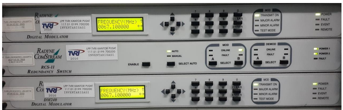
Gambar 3.9 Digital Modulator IF dan Redundancy Switch
