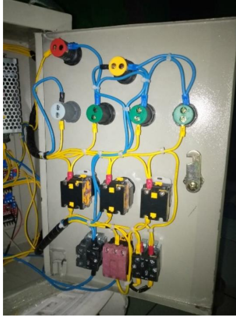
Gambar 4. 2. Kelistrikan dibagian pintu panel
