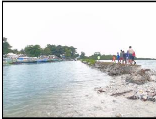
Gambar 2. Kondisi Dermaga Pulau Sabira
