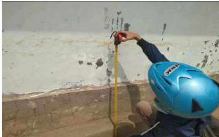
Gambar 4.17. Pengukuran jejak tsunami Banten Tahun 2018 di rumah warga Desa Panimbangjaya
