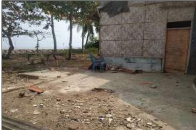
Gambar 4.21. Kondisi rumah warga rusak berat di Desa Panimbangjaya
