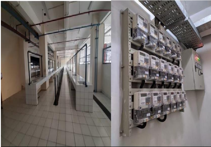
Kondisi kelistrikan Rusunawa di wilayah Jakarta Utara Sumber; dokumentasi peneliti
